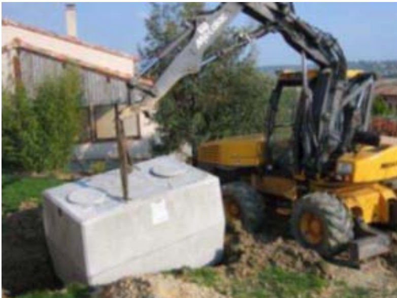
Exemple de cuve enterrée
